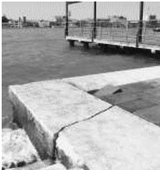
La riva recentemente consolidata alle Zattere sta già cedendo. Bortoluzzi chiede più controlli sui cantieri.
